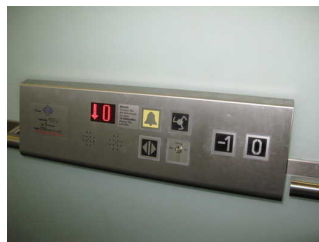
Aufzug ins Untergeschoß
