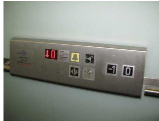
Aufzug ins Untergeschoß
