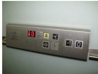
Aufzug ins Untergeschoß
