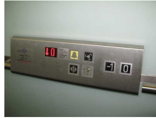
Aufzug ins Untergeschoß
