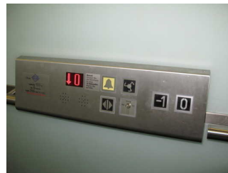
Aufzug ins Untergeschoß
